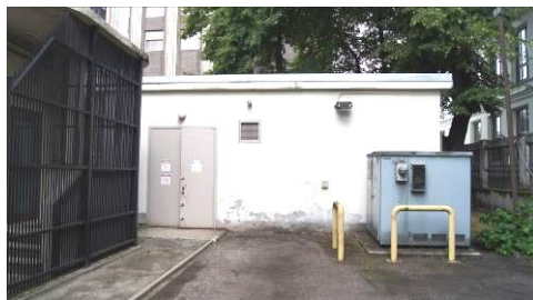
Ģenerators ēka un transformatora apakšstacija
